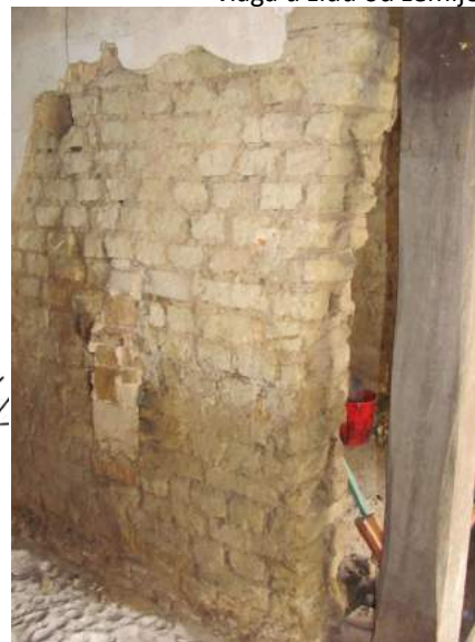
vlaga u zidu od zemlje
